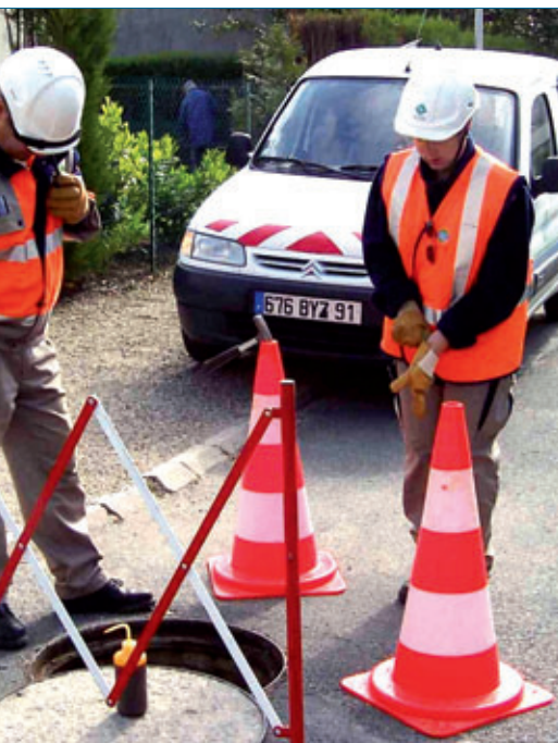
Contrôle de conformité d'une installation privée par les services techniques du délégataire.
